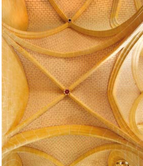
Trompe-l'œil de faux joints La clé de voute en rosace est peinte.
